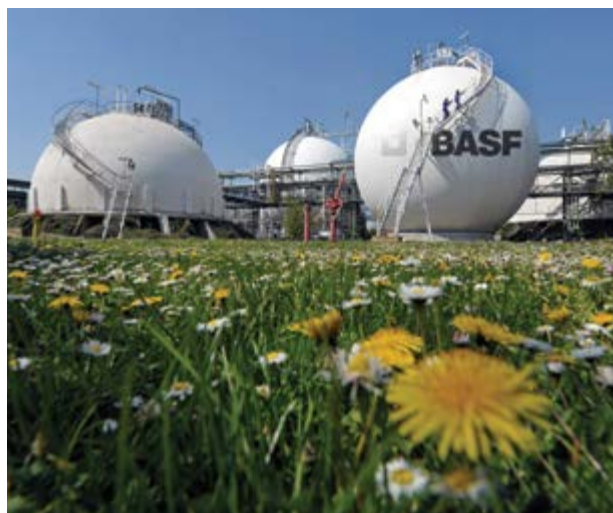
Instalación de almacenamiento en tanques en la Isla de Friesenheim en Ludwigshafen.
